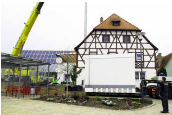
In der Ortsmitte wurde im November ein „Point of Presence“ (PoP) in Form eines teilweise begehbaren Betonkörpers am Eingang zum Grünzug installiert. Nach Christian Lutz, dem Leiter des Röttenbacher Bauamts, ist der PoP die Schnittstelle zwischen dem Kernbereich des Telekommunikationsnetzes (Backbone), der die extrem hohe Datenübertragungsraten bereithält, und dem neuen Röttenbacher Netz bis hin zum Anschluss des Bürgers. Im PoP-Gebäude wird das Signal, das für die Datenübertragung in Lichtgeschwindigkeit zunächst gebündelt eintrifft, technisch gesplittet. Vereinfacht ausgedrückt: „In dem Gebäude werden die weltweiten Daten verteilt und die einzelnen Glasfasern mit Daten-Lichtsignalen belegt, die dann bis zum Abschlusspunkt im Haus durchlaufen. D.h., jedes Anwesen hat eine direkte Verbindung zum POP-Gebäude.“ (C. Lutz). Im Bild: Das PoP-Bauteil wird an der Bushaltestelle in der Rother Straße vom Schwertransporter an den Schwerlastkran übergeben.
